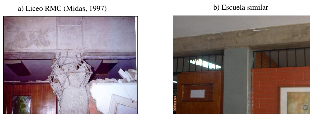
Figura 6. Falla en columna corta del Liceo RMC y comparación con columna de otro Cajetón.
